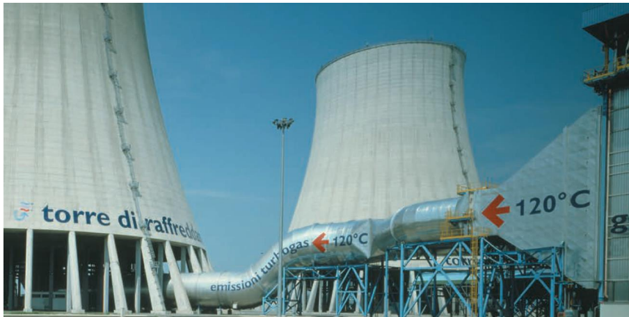
Figura 1-28 Progetto: Michele De Lucchi - Committente: Enel produzione - Luogo: Trino Vercellese (VC) - Anno: 1999
