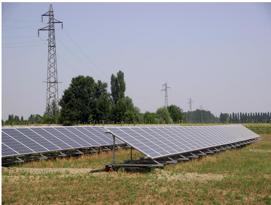
Figura 6-3 Esempio di campo Fotovoltaico a Terra
